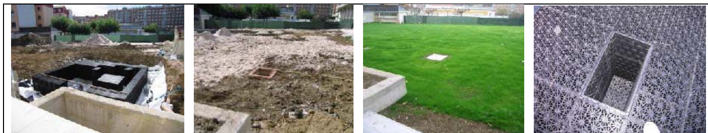
Sistema SUDs en Unión Deportiva Rochapea (Fuente: DURSO) Tanque retención. Drenaje bajo la zona de estancia ajardinada de las piscinas.
